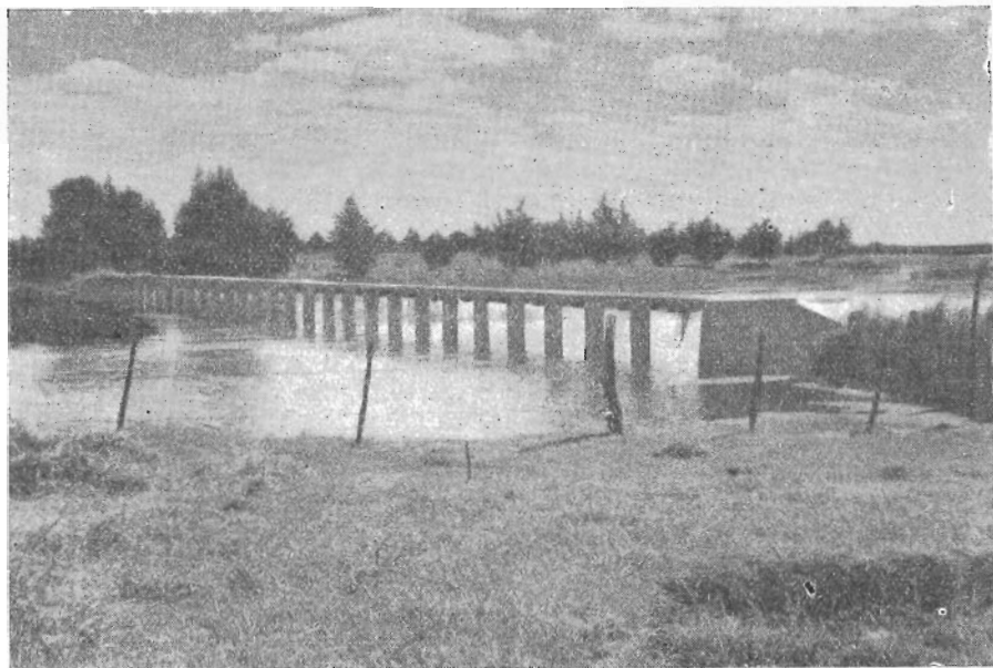
Fig. 28.—Compuerta de la laguna Vitel rebalsada por el agua. (Foto L. Ferreyra, octubre de 1958)
