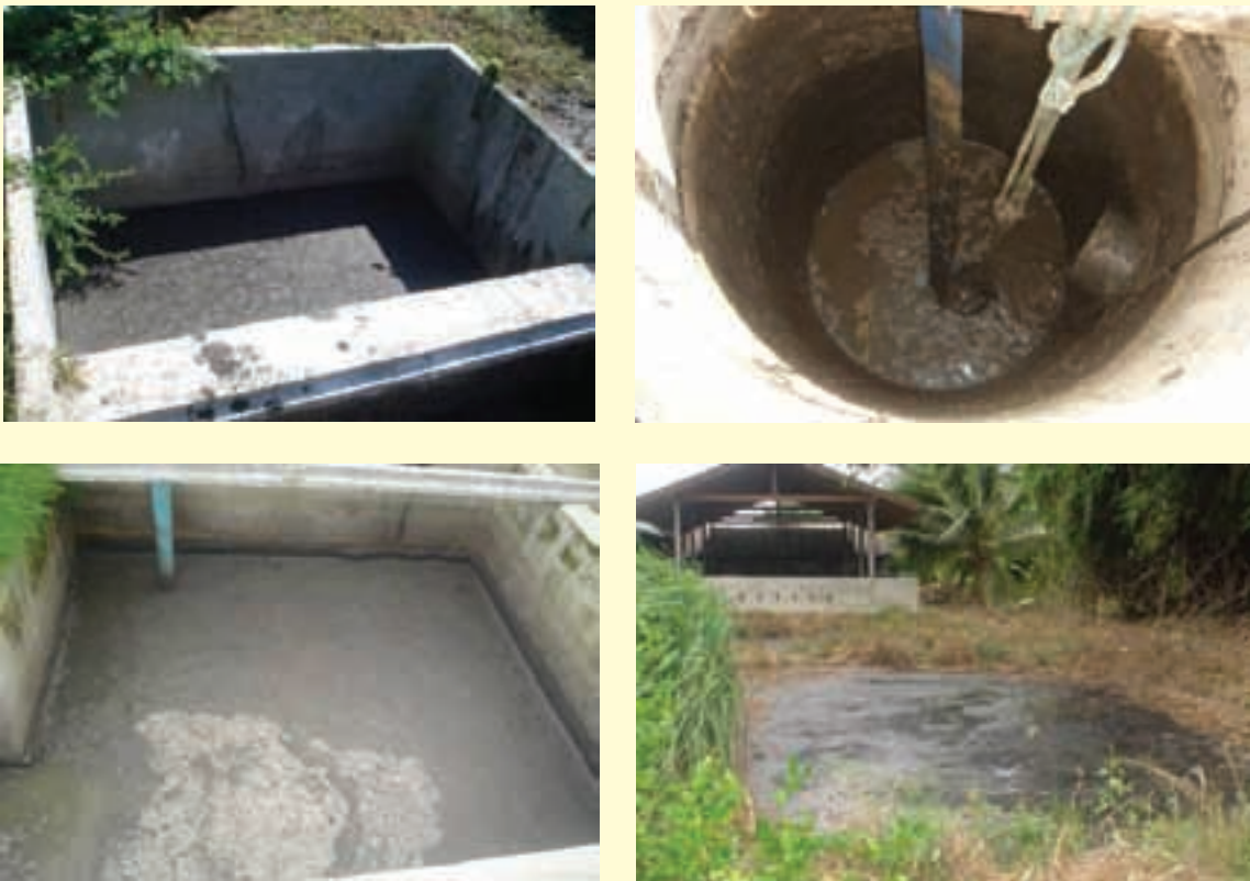
รูปที่ 3-6 บ่อรวบรวมน้ำเสีย
