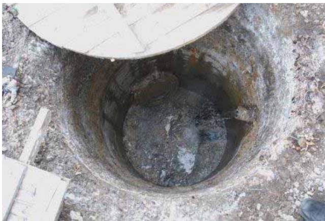
Фото 1. Колодец без плиты перекрытия, крышка на дне
