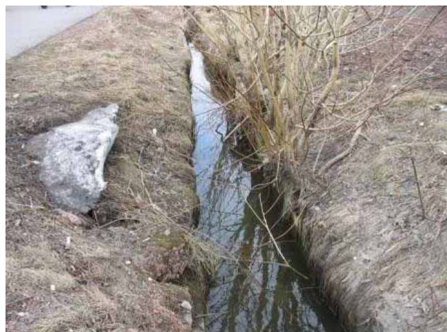
Фото 10. Лотки для отвода поверхностных вод
