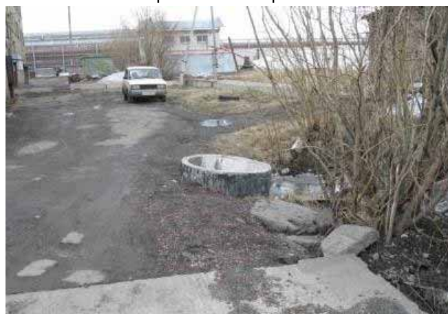
Фото 6. Колодец без плиты перекрытия, заполненный водой
