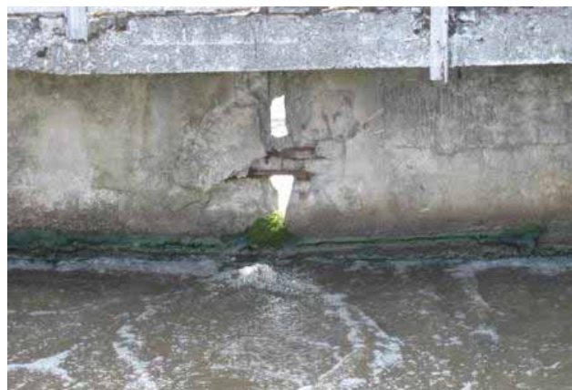
Фото. 2. Дефекты железобетонной стены аэротенка
