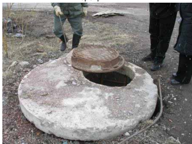
Фото 4. Колодец с дефектной плитой перекрытия и негерметичной горловиной
