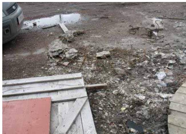
Фото 8. Разрушенная плита перекрытия
