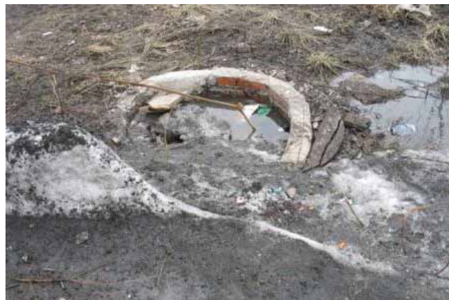
Фото 2. Колодец, заполненный водой без плиты перекрытия
