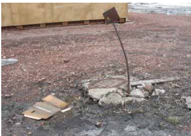
Фото 5. Колодец с разрушенной плитой перекрытия
